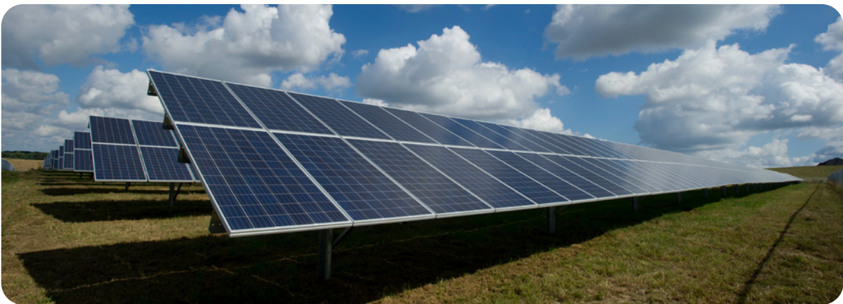
Instalaciones de energía renovable
